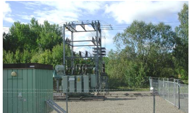
Luftställverk på Valla 1:41
